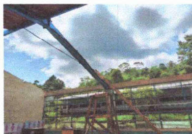
Foto 2: Cambiando las cubiertas de la costanera ya no estan en buenas condiciones Pde la escuela ya no estan completas se añade con un pedazo de madera
